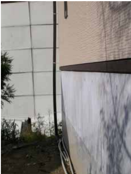
写真 4.3.4 濁沢 住宅 C 建物全体が沈下
