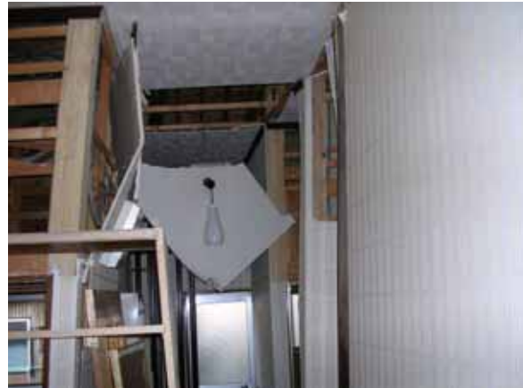
写真 4.3.27 六日市町 住宅 J 内部 ボード状の天井や内装材が脱落
