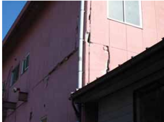
写真 4.3.21 川口町 3F 建て店舗 ALC 外壁の損傷
