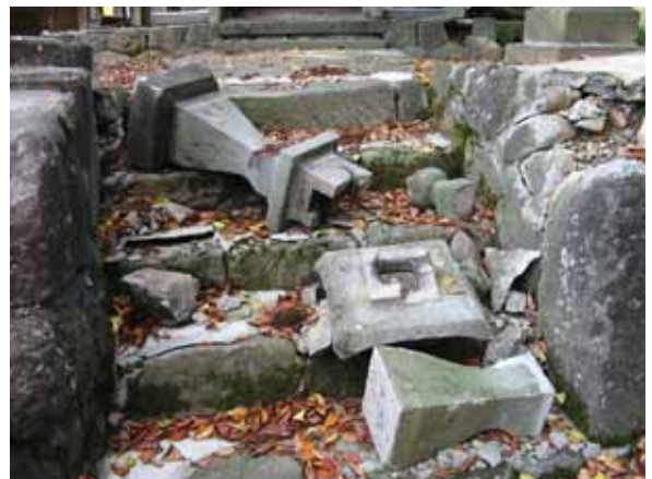
写真 4.3.34 濁沢 石灯笼の倒壊
