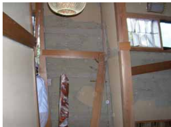
写真 4.3.28 六日市町 住宅 J 内部 土塗り壁が脱落
