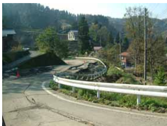
写真 4.1.6 小千谷市の地滑り現場
