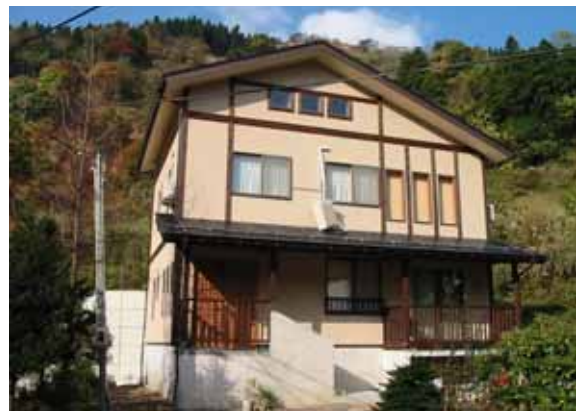
写真 4.3.1 濁沢 住宅C(窯業系サイディング張り 金具留め工法) 室外機が脱落。
