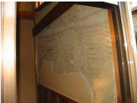
写真 4.3.31 六日市町 住宅 J の内部 土塗り壁の脱落
