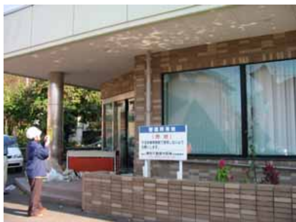
写真 4.3.23 川口町 要注意表示建物 乾式タイル外壁 部分的に損傷
