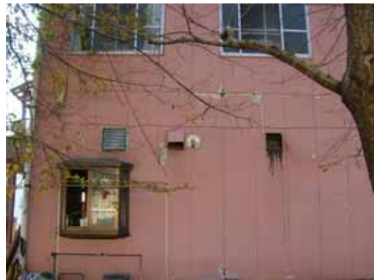
写真 4.2.37 川口町 越後川口駅前 ALCの損傷状況
