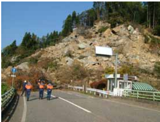
写真 4.1.8 長岡市妙見町の土砂崩れ現場
