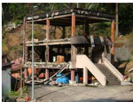
写真 4.1.1 長岡市濁沢町の火災現場
