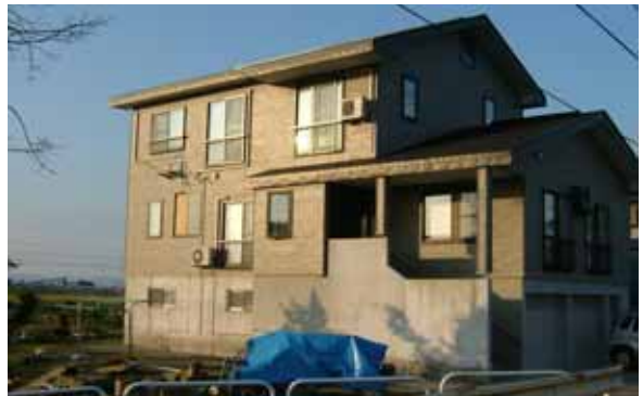
写真 4.3.11 六日市町 住宅 F 窯業系サ イディングに外観上の被害は見受けられな い。
