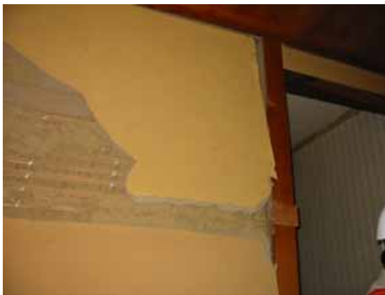
写真 4.3.30 六日市町 住宅 J の内部 土塗り壁の脱落
