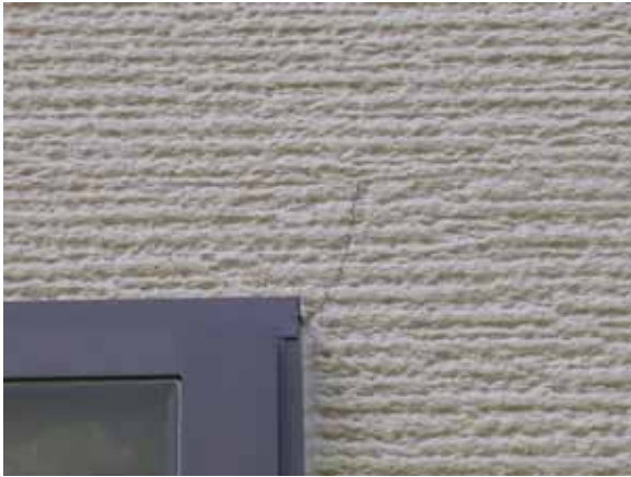
写真 4.3.2 濁沢 住宅 C 開口部まわりのクラック
