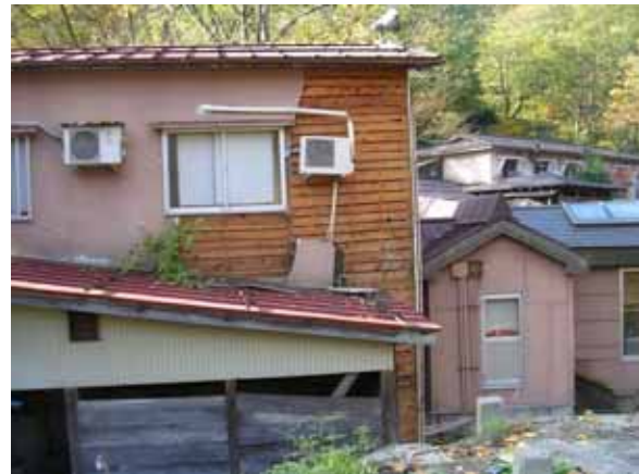
写真 4.3.16 濁沢 旅館 モルタルが脱落
