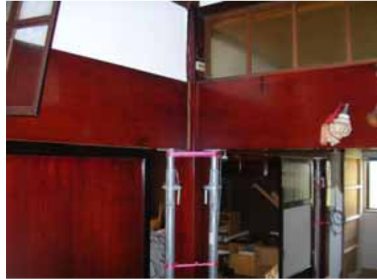
写真 4.2.30 吉谷 住宅 L 外観上は大きな損傷は見られなかったが、せいの大さな差し鴨居が大黒柱から抜けかかっていた。
