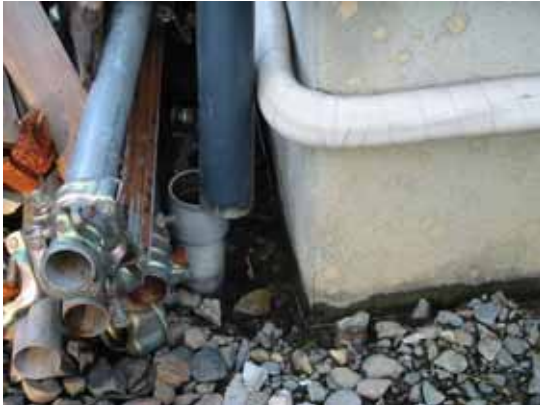
写真 4.2.15 蓬平 郵便局縦樋と排水パイ プのずれは地震によるものか
