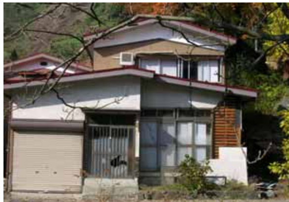
写真 4.3.12 濁沢 住宅 G 構造上の大き な被害は見受けられないが、モルタル外壁 が脱落。
