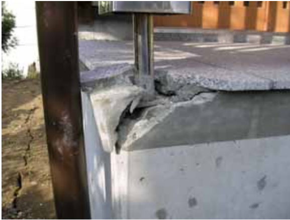
写真 4.3.3 濁沢 住宅 C 玄関まわりポーチ柱の脚部破損
