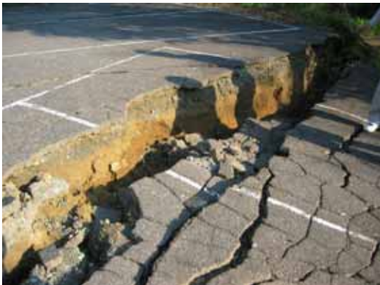
写真 4.1.9 地面の亀裂・陥没
