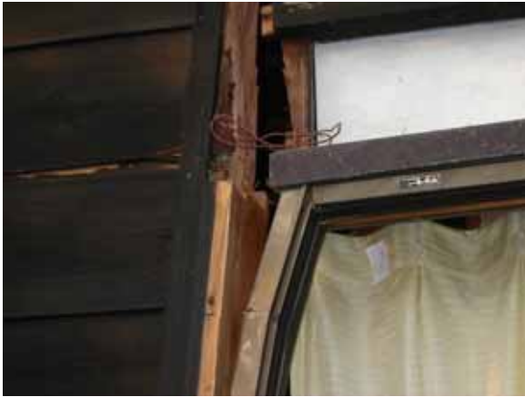
写真 4.3.29 六日市町 住宅 J アルミサッシの変形
