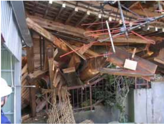
写真 4.2.28 両新田 住宅 K ほぼこの状態で、余震の中二人の子供が救出された。高床基礎の剛性に比べ上部構造があまりにも軟弱だったと推察される。
