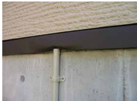
写真 4.2.9 濁沢住宅C 基礎が十数ミリ沈んだ可能性あり
