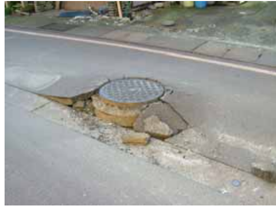
写真 4.1.10 マンホールの浮き上がり
