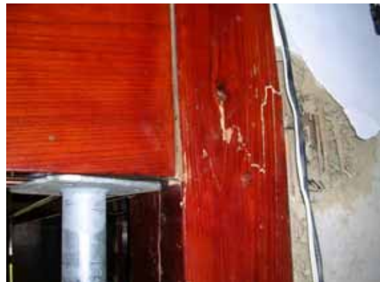
写真 4.2.31 吉谷 住宅 L 径の小さな柱は、差し鴨居の位置で折損
