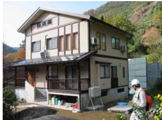
写真 4.2.8 濁沢 新築間もない住宅C 2階の室外機が外れている他は、外観上大きな損傷は見つからない。
