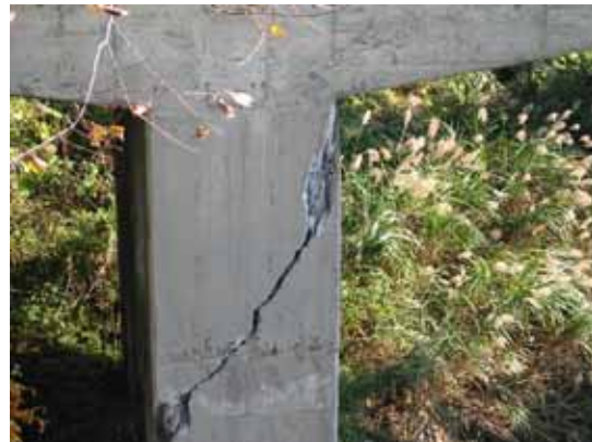
写真 4.1.12 道路橋脚の亀裂
