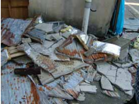
写真 4.3.18 川口町 店舗 ラスシートとともに脱落したモルタルの破片。角波亜鉛鉄板が腐食している。
