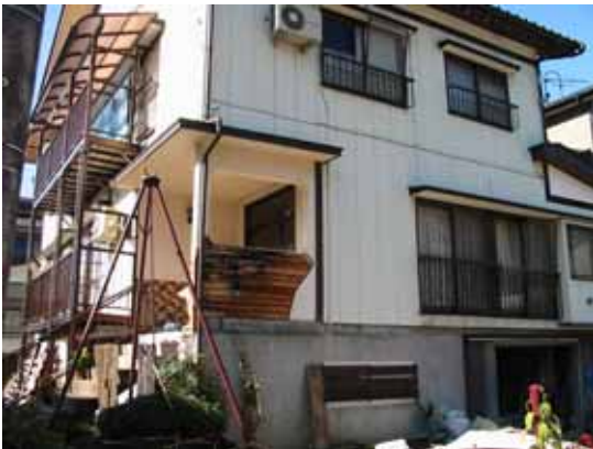
写真 4.3.19 川口町 住宅 I 玄関まわりの腰壁のモルタルが脱落。壁面の金属サイディングは脱落なし。
