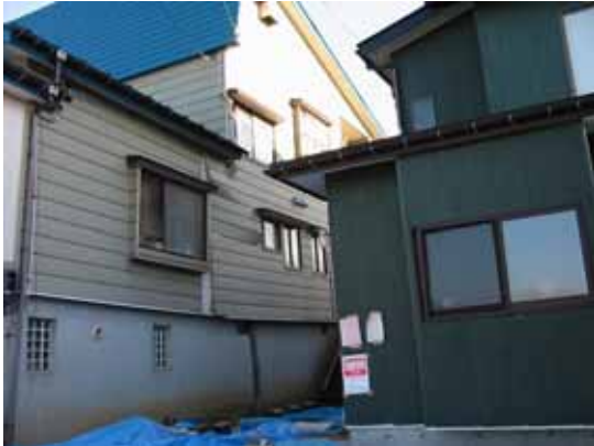
写真 4.2.4 高町団地 高台の造成団地外周部の法面崩落に伴う地盤沈下
