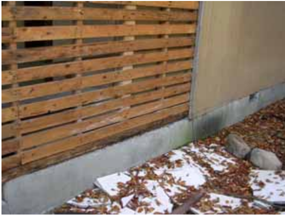
写真 4.3.13 濁沢 住宅 G 木摺りを残しラスモルタルが脱落。土台部の木摺りの腐食が見られる。
