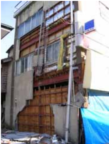
写真 4.2.34 川口町 越後川口駅前通 鉄骨3階建てラーメン構造店舗 ラスモル タルは脱落していた。
