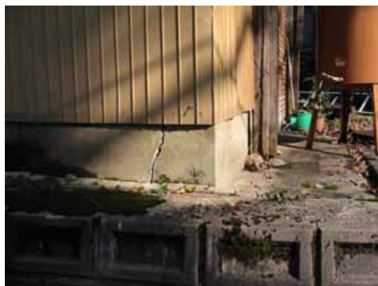
写真 4.2.13 濁沢 無筋と思われる布基礎のひび割れ
