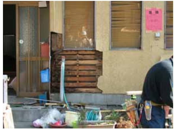
写真 4.3.15 川口町 住宅 H モルタルが木摺りより部分的に脱落
