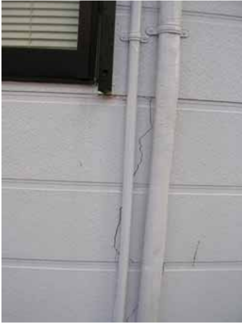
写真 4.3.8 蓬平町 郵便局（木造） 全幅にわたるクラック
