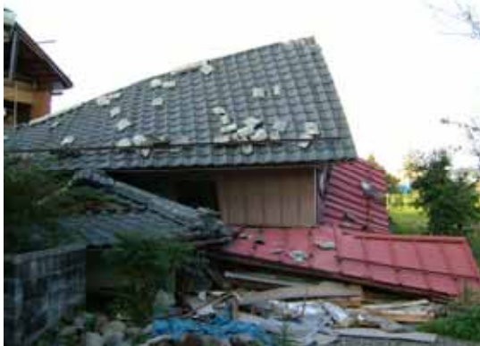
写真 4.1.3 長岡市六日市町の倒壊住宅
