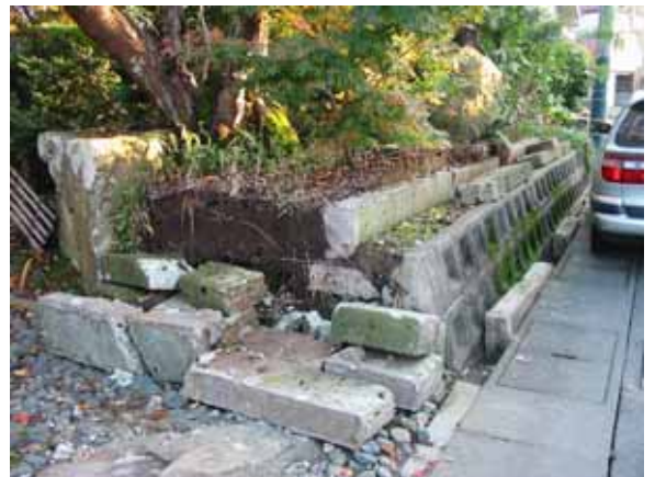
写真 4.3.33 六日市町 石垣の崩落
