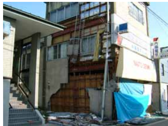
写真 4.3.17 川口町 店舗 鉄骨造+モルタル ラスシート下地のモルタルが脱落。
