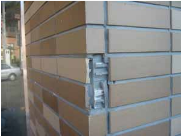
写真 4.3.24 川口町 要注意表示建物 乾式タイル外壁 出隅部の部分的な損傷
