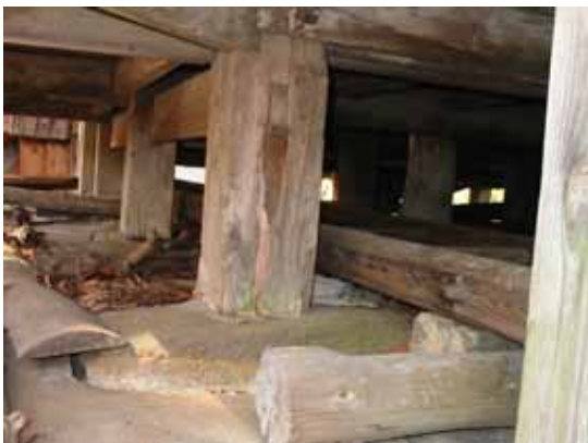
写真 4.2.12 一部基壇が崩壊し、束と束石がずれていたが、礎石と柱にずれはないように見える。
