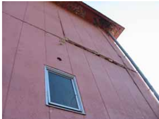
写真 4.3.22 川口町 3F 建て店舗 ALC 外壁の損傷
