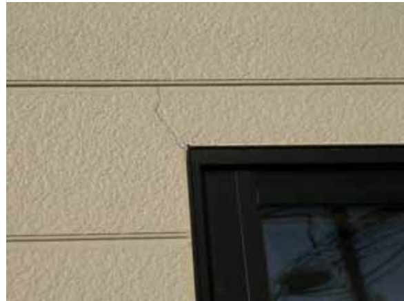
写真 4.3.6 蓬平町 住宅 D 開口部まわりのクラック
