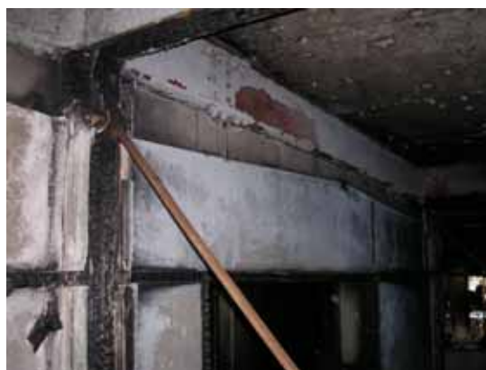
写真 4.2.2 共同住宅A内部の状況 地震による被害と、ガス爆発による被害とが見分けが付かない状態
