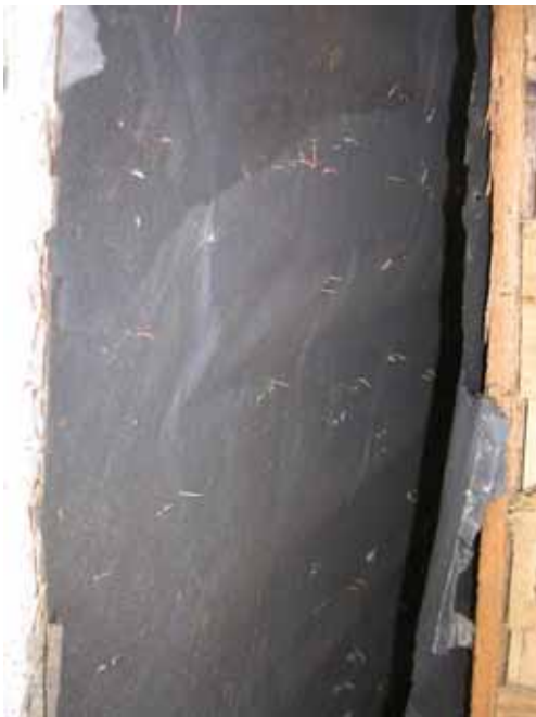
写真 4.3.14 濁沢 住宅 G 脱落したモルタル ステーブルが、木摺りより抜け落ち ている。
