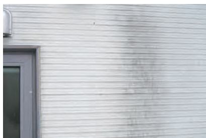
経年によってつく汚れ
