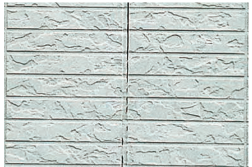
シーリング目地に生じた剥離の例
