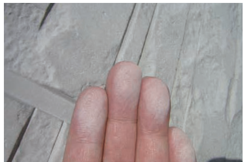
塗装面を手でこすって白い粉が付着した例
