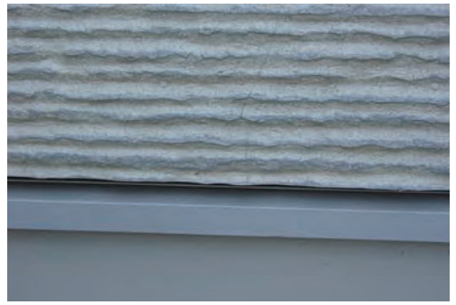
地震などで微細な亀裂(クラック)が入った例
