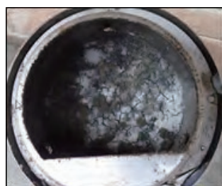
換気フードの網目詰まり状態
