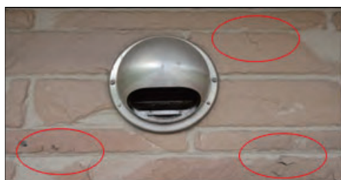
換気フード周辺の凍害現象
