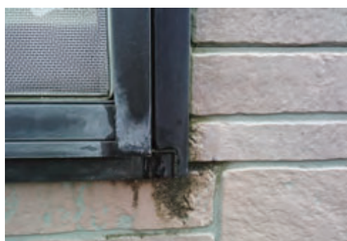
伝い水による汚れ
