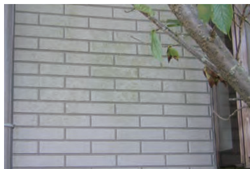
藻による汚れの例
