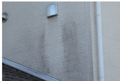
換気フード周辺の汚れ
