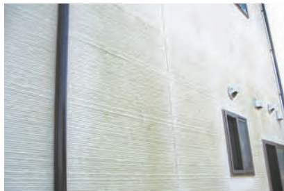
藻が発生した外壁
